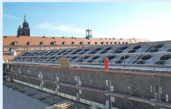
Structure des 20 aéroréfrigérants en position inclinée ; en arrière plan, on voit les tours de l'église Sainte-Croix (Kreuzkirche) et de l'hôtel de ville de Dresde
