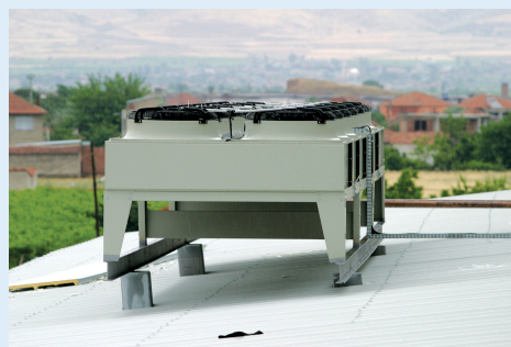
Condenseur à ventilateurs hélicoïdes Güntner GVH : Malgré des températures extérieures de 35 °C, les condenseurs Güntner développent une capacité de condensation suffisante et les évaporateurs Güntner maintiennent à l'intérieur une humidité relative de 98 %.
