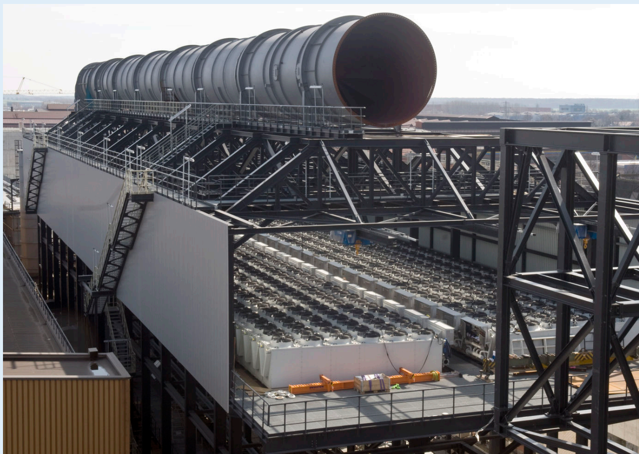
Güntner a livré au total 64 aéroréfrigérants pour cette installation
