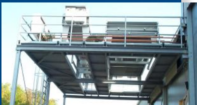
Condenseur disposé sur une structure en acier à côté de la salle des machines
