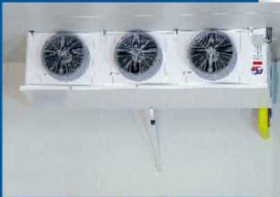
Les Vario CUBIC GHN Güntner de l'entrepôt frigorifique ont une faible différence de température entre l'air fourni et l'air rejeté. Ce choix est destiné à empêcher une perte de poids des fruits et des légumes crus due à l'évaporation.
