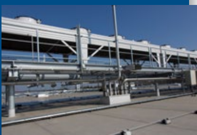
▲ Les condenseurs Güntner délivrent une puissance totale de 3 100 kW et sont disposés en groupe sur le toit, à côté de l'équipement photovoltaïque.
