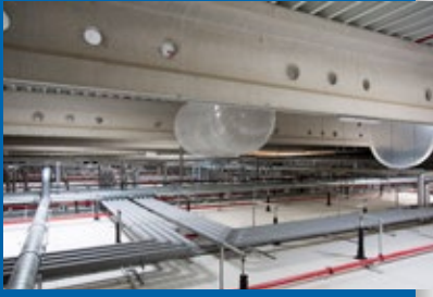
▲ L'imposante tuyauterie, les « shut-ups » de l'équipement de pressurisation AC/ULO ainsi que l'installation d'extincteurs à sec sont placées au-dessus des entrepôts.
