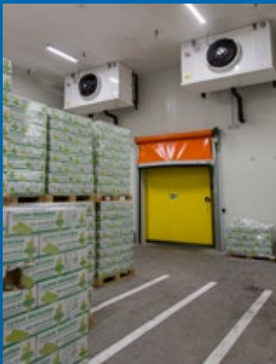
▲ Deux chambres de refroidissement sont alimentées au moyen de cinq évaporateurs directs au CO 2 de type CXGHN. Le dégivrage est assuré par un circuit de saumure chaude séparé et intégré.
