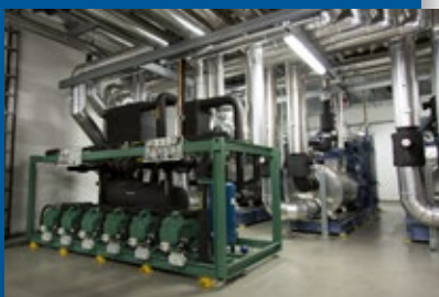
▲ L'installation au CO 2 (t 0 = -35 °C) fonctionne exclusivement dans le domaine sous-critique et est constituée d'un groupe de six compresseurs, chacun d'eux ayant une puissance frigorifique de 65 kW.
