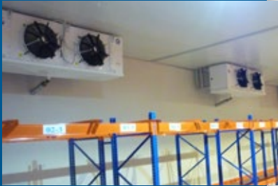
▲ Huit refroidisseurs d'air CUBIC Vario AGHN de Güntner et des évaporateurs directs de différentes dimensions assurent la répartition uniforme du froid dans les chambres de stockage.
