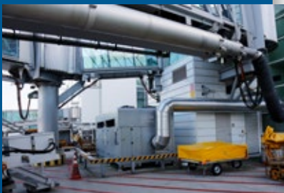
▲ L'air est injecté sous haute pression dans les canalisations étroites de distribution d'air de l'avion, par l'intermédiaire d'une combinaison de tubulures fixes et de tuyauteries souples.
