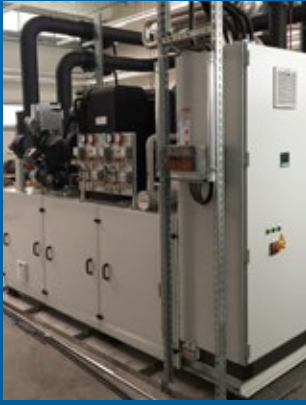
▲ Les compresseurs de la machine frigorifique sont pourvus d'un boîtier insonorisé.
