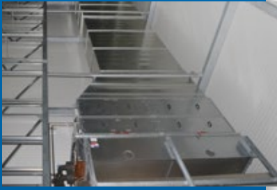
▲ À l'aide de deux refroidisseurs à saumure sur pieds Güntner FLOOR, de type GSN, le froid est transmis à l'entrepôt à houblon maintenu en permanence à la température de 2 °C.
