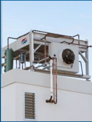
▲ Un condenseur Güntner FLAT Compact GVHX avec sous-refroidisseur séparé Güntner VERTICAL Compact GSVC en technologie microox, sur le toit de la salle des machines.
