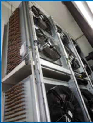
▲ Les ventilateurs refoulants des refroidisseurs Guntner Application BLAST, type GFN, sont installés à l'arrière de la chambre climatique.
