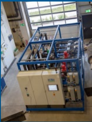
▲ Le banc d'essai CO 2 performant de TÜV SÜD à Olching fournit des données claires sur la puissance, par exemple pour les groupes compresseur-condenseur ou les armoires frigorifiques commerciales.
