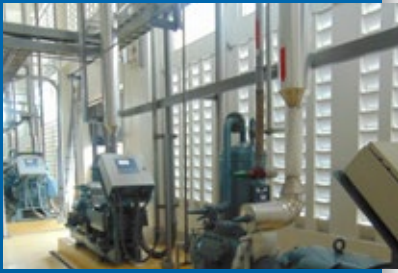
▲ Compresseurs au NH 3 et au CO 2 dans la salle des machines.
