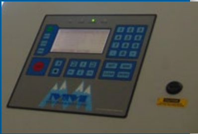
▲ Armoire électrique pour la commande des compresseurs dans la salle des machines.
