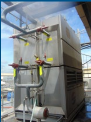
▲ Deux condenseurs évaporatifs Güntner ECOSS transmettent la chaleur excédentaire des compresseurs au NH 3 à l'environnement.
