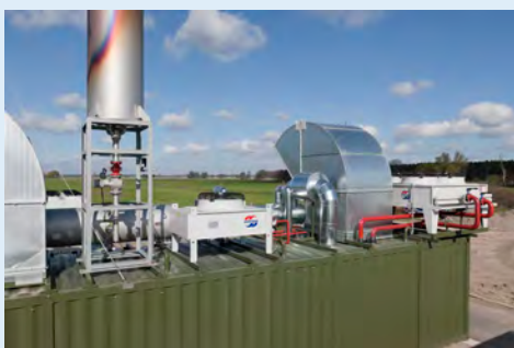
Appareil à gauche : aéroréfrigérant GFH de Güntner comme refroidisseur de mélange ; appareil de droite : aéroréfrigérant GFH de Güntner comme refroidisseur de secours, pouvant être utilisé en cas de travaux d'entretien à la centrale de cogénération.
